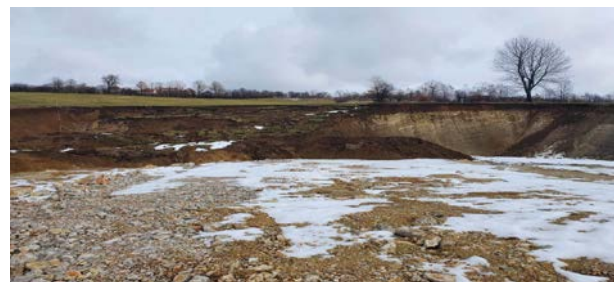
Slika 1. Klizište na iskopu temelja.
